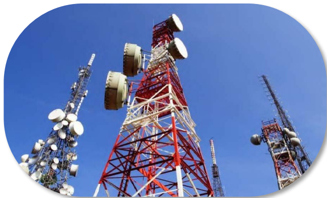
Antenas de Telecomunicaciones
