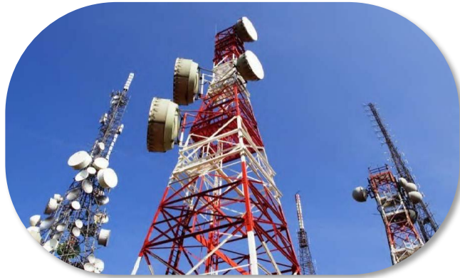
Antenas de Telecomunicaciones
