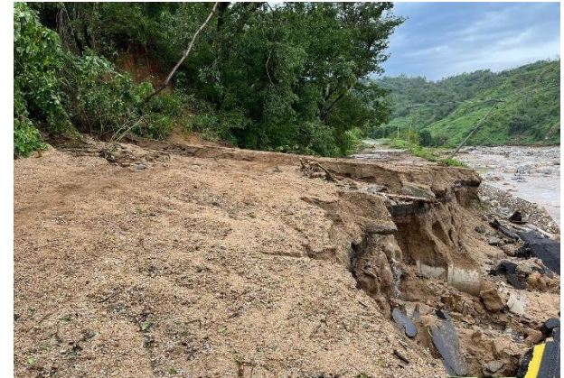
Foto 6. Carretera Chilpancingo – Acapulco, en el Estado de Guerrero, octubre 2023
