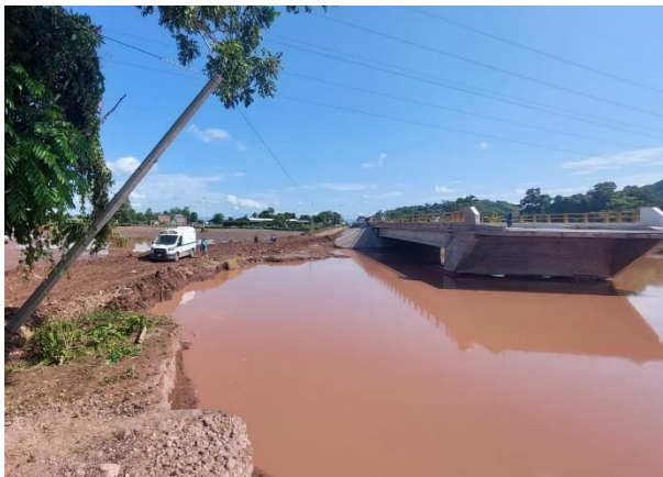
Foto 19. Estado de Nayarit, puente “Tuxpan” localizado en el Ramal a Tuxpan, octubre 2021.
