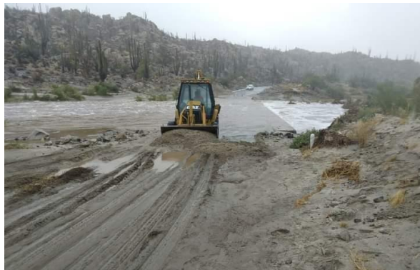
Foto 12. Carretera Ciudad Insurgentes – Loreto, Estado de Baja California Sur, agosto 2023
