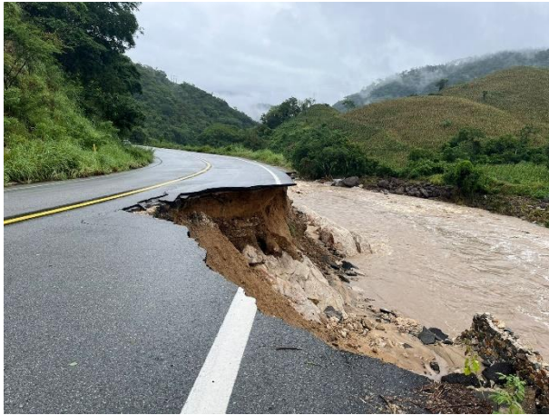
Foto 5. Carretera Chilpancingo – Acapulco, en el Estado de Guerrero, octubre 2023
