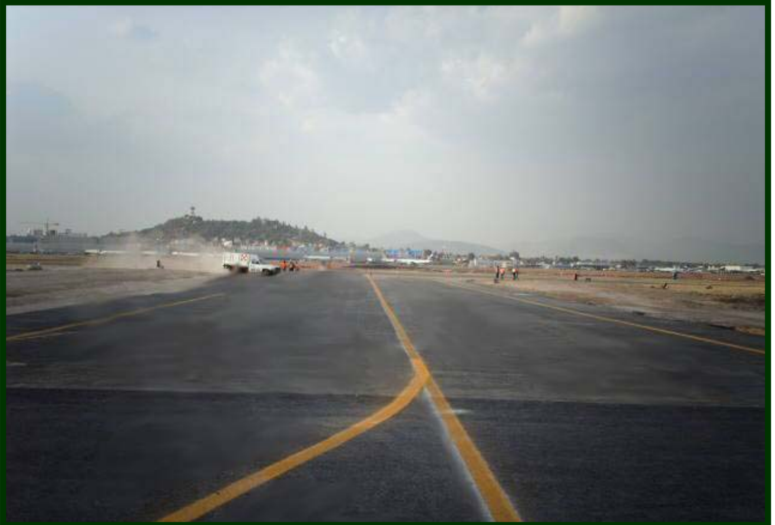
Aeropuerto Internacional de la Ciudad de México (AICM). Rehabilitación del rodaje de acceso y plataforma para instalaciones de AVIACSA.
