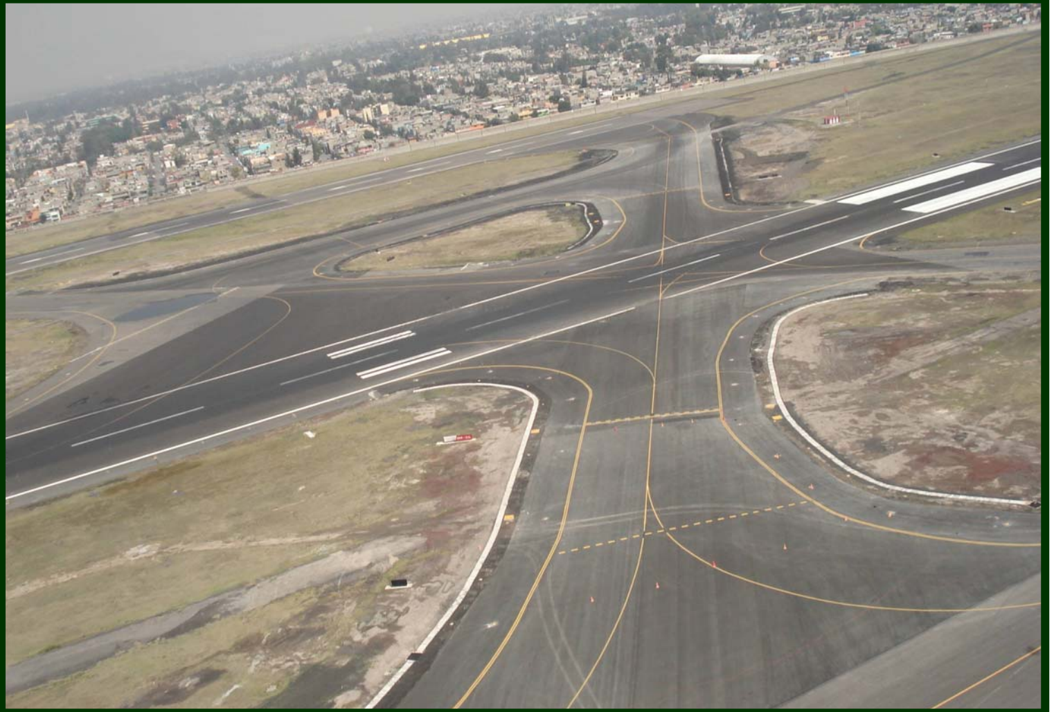
Aeropuerto Internacional de la Ciudad de México (AICM). Construcción del nuevo rodaje hotel y hotel 1, ambos incluyen márgenes laterales, así como ayudas visuales.
