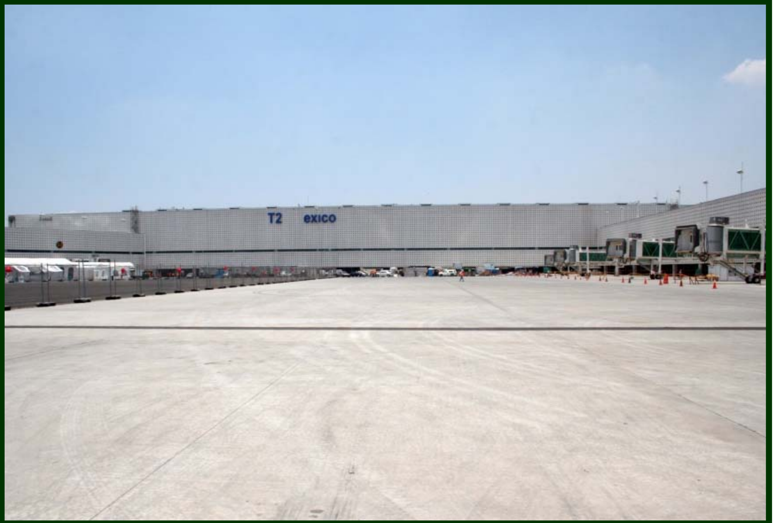
Aeropuerto Internacional de la Ciudad de México (AICM). Sistema de Transporte Automatizado (Aerotrán) y construcción del edificio terminal de la T2.
