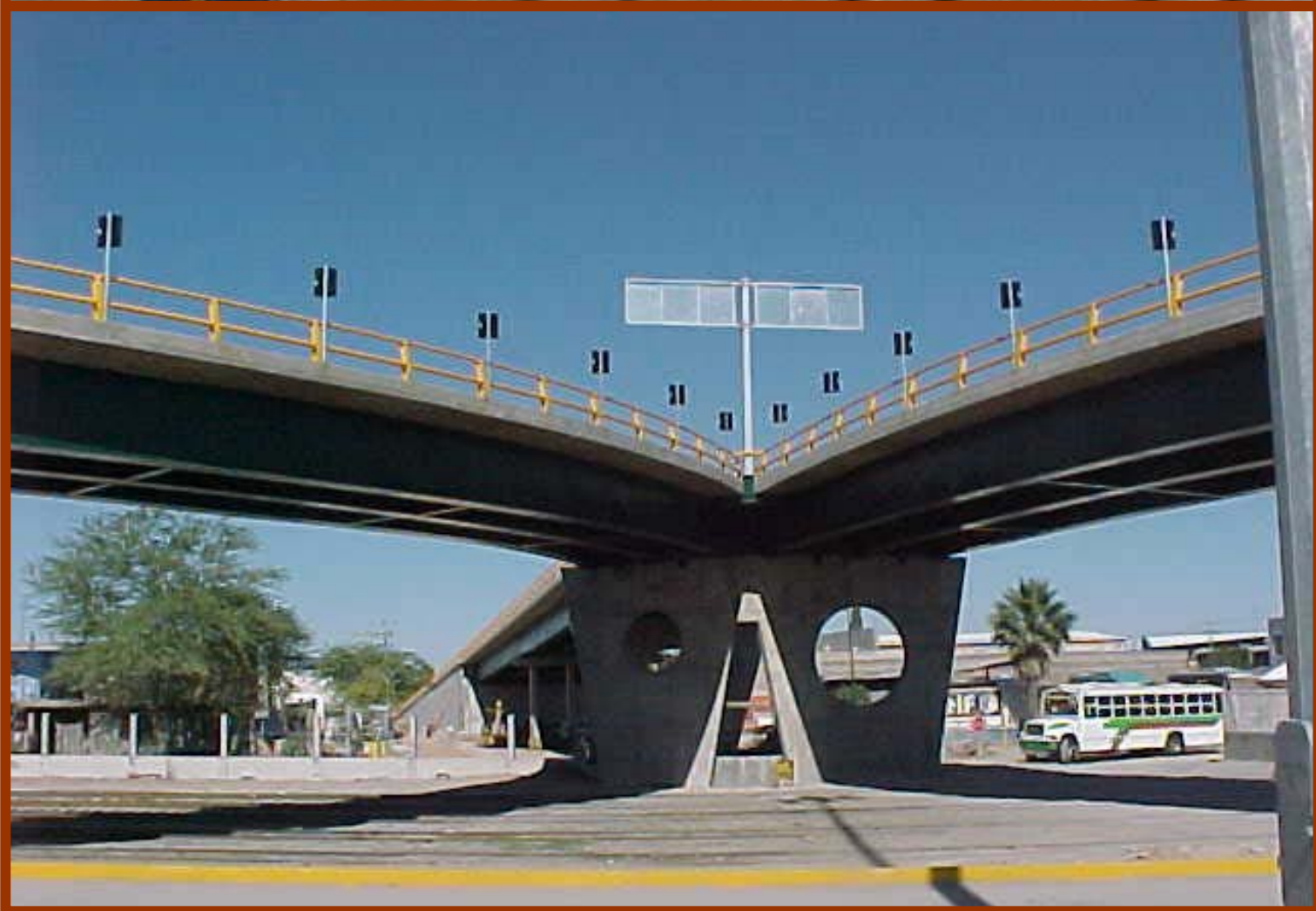
Paso a desnivel superior en la intersección con la Av. Cuauhtémoc y la Vía México-Ciudad Juárez en Torreón, Coah.
