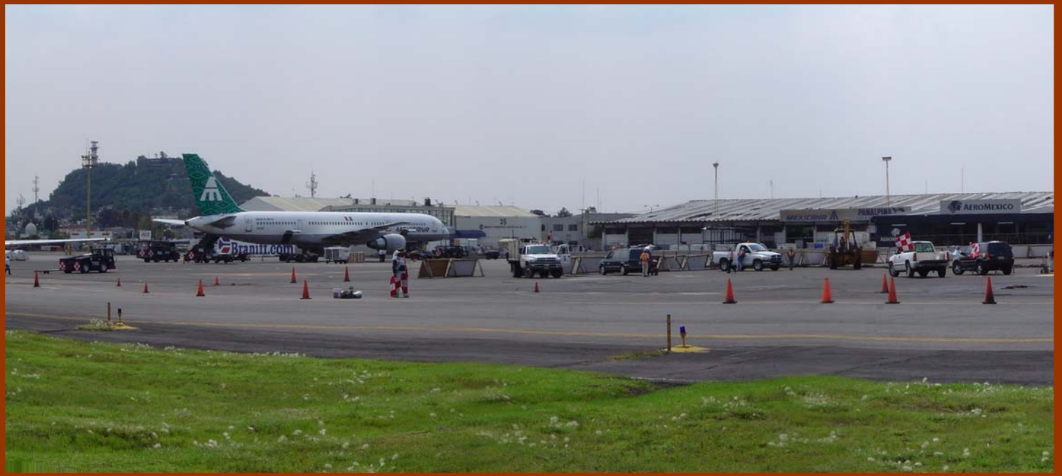
Ampliación de reclamo nacional, sala de preespera Bravo y rehabilitación de la plataforma de la aduana, Aeropuerto Internacional de la Ciudad de México (AICM)
