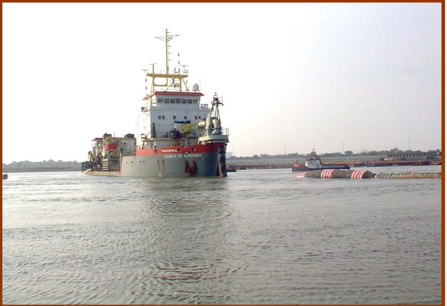
Construcción de protección marginal y dragado en canales y dársenas, Lázaro Cárdenas, Mich.
