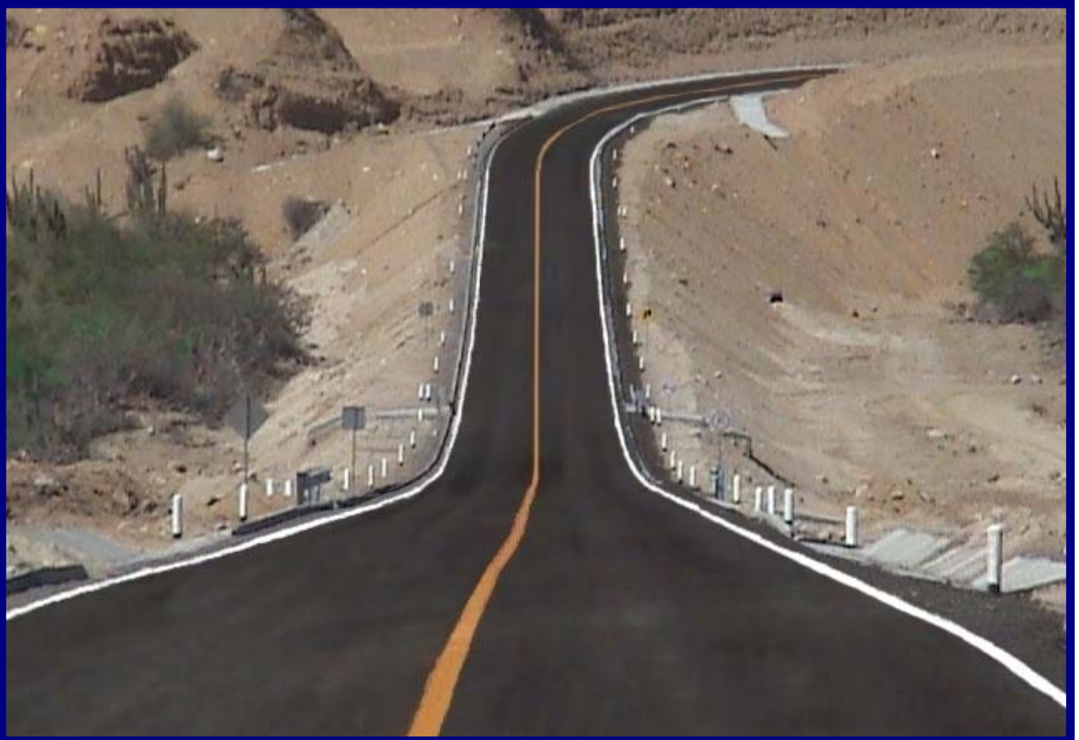
Carretera: Costera del Golfo, B.C.S. Tramo: Los Barriles - El Cardonal
