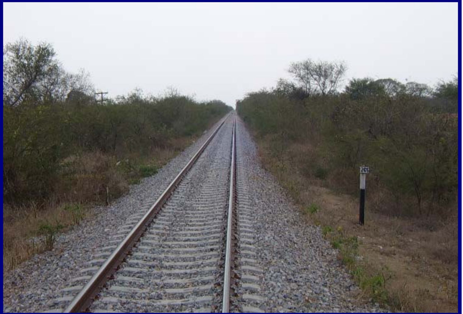
Ferrocarril del Istmo de Tehuantepec (FIT). Conservación mecanizada de vía, línea Z km 254 + 437 Ixtepec, Oax y km 265+000 Comitancillo, Oax.
