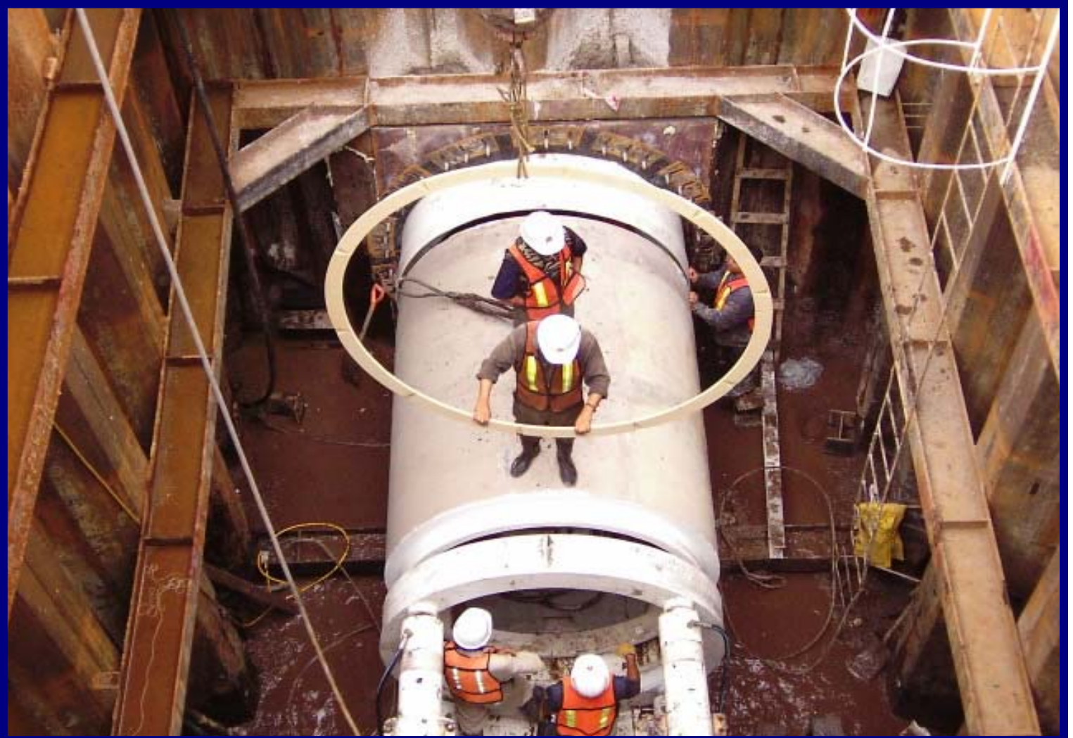
Aeropuerto Internacional de la Ciudad de México (AICM). Construcción de colector semiprofundo.
