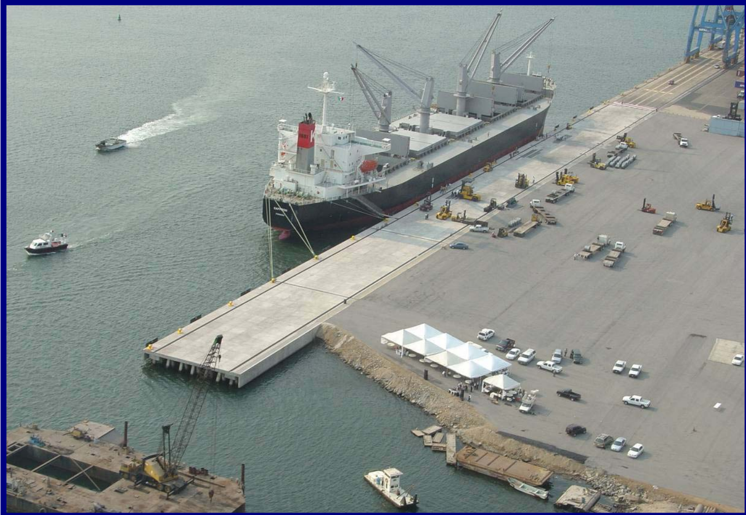
Construcción de muelle anexo a la posición de atraque número 11, Manzanillo, Col.
